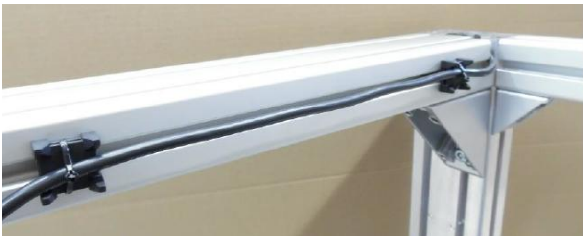
Abbildung 28: Kabelführung mit Kabelhaltern
